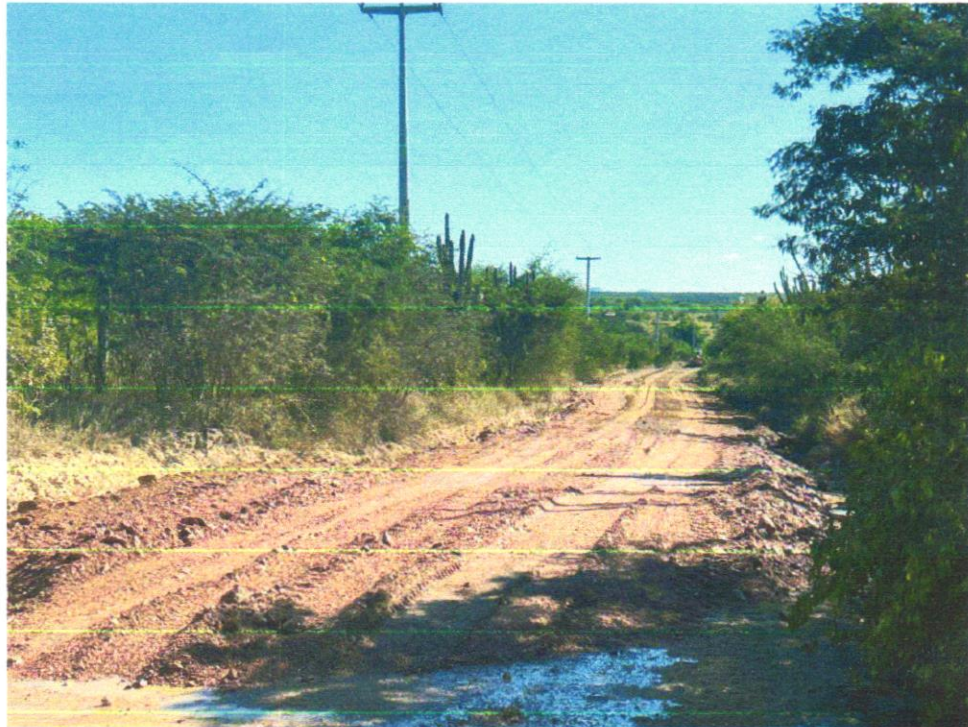
Foto 07 - EXECUÇÃO E COMPACTAÇÃO DE ATERRO COM SOLO PREDOMINANTEMENTE ARGILOSO - EXCLUSIVE SOLO, ESCAVAÇÃO, CARGA E TRANSPORTE. AF_11/2019
