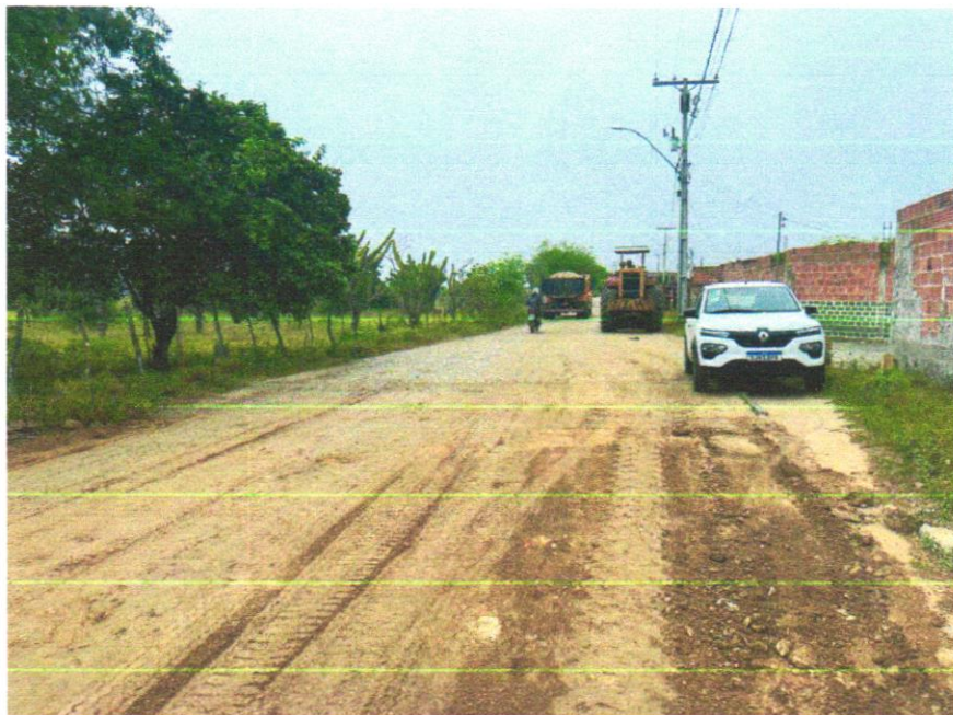
Foto 06 - TRANSPORTE COM CAMINHÃO BASCULANTE DE 6 M 3 , EM VIA URBANA EM LEITO NATURAL (UNIDADE: M3XKM). AF_07/2020
