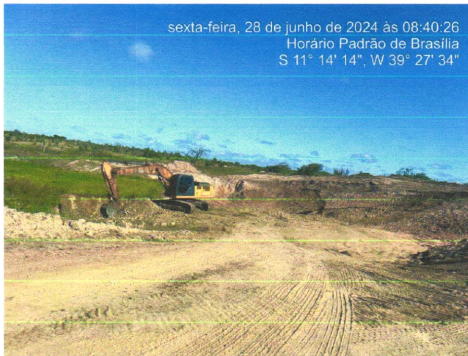
Foto 03 - ESCAVACAO E CARGA MATERIAL 1A CATEGORIA, UTILIZANDO TRATOR DE ESTEIRAS DE 110 A 160HP COM LAMINA, PESO OPERACIONAL * 13T E PA CARREGADEIRA COM 170 HP.
